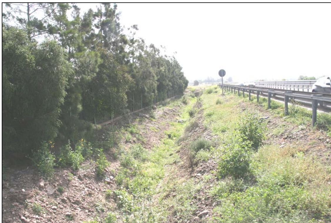
Figura 4 - Canale di guardia lungo la S.S. n. 130
